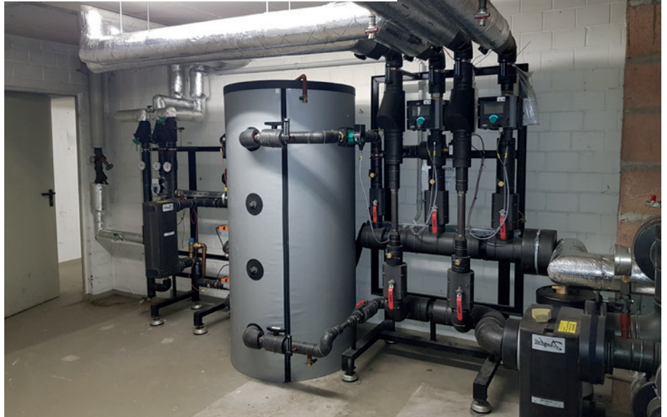
Klar im Vorteil, wenn es um die Umwelt geht: die neue Fernwärmanlage im Feuertornweg 1 – 6
